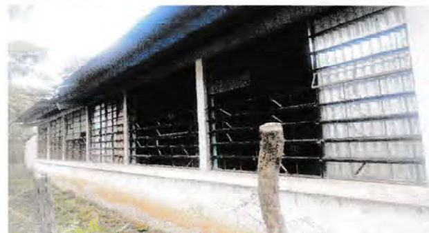
Foto 2: los ventanales se encuentran en malas condiciones vidrios en total deterioro
