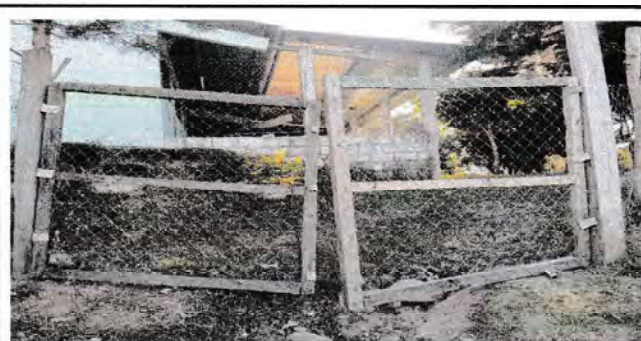
Foto 6: Puerta principal se encuentra en total deterioro
